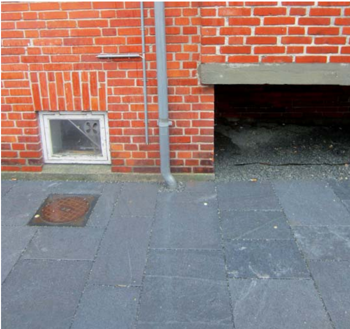
Ved Stiholmvej i Birkerød ledes tagvand fra en beboelsesbygning til bærelaget i den permeable befæstelse.
