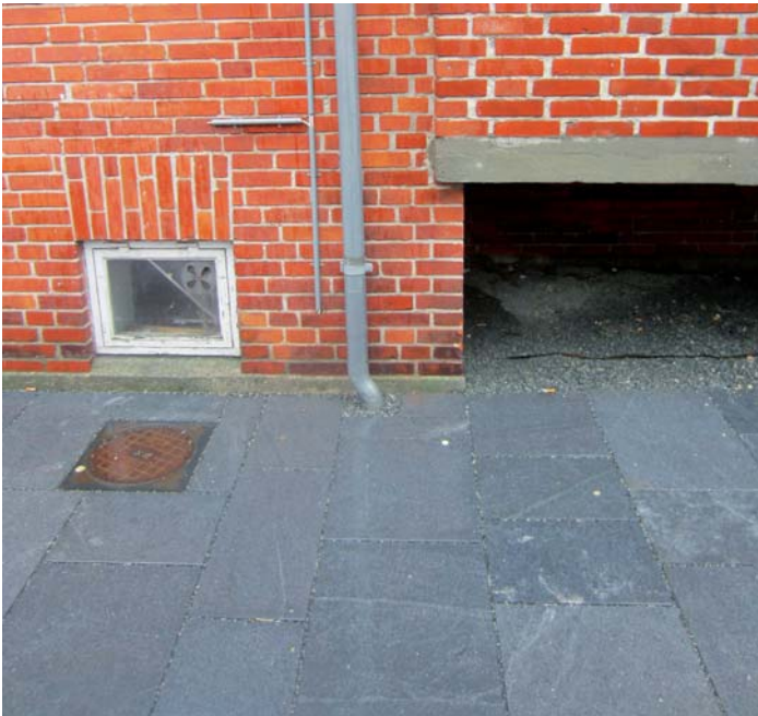
Ved Stiholmvej i Birkerød ledes tagvand fra en beboelsesbygning til bærelaget i den permeable befæstelse.
